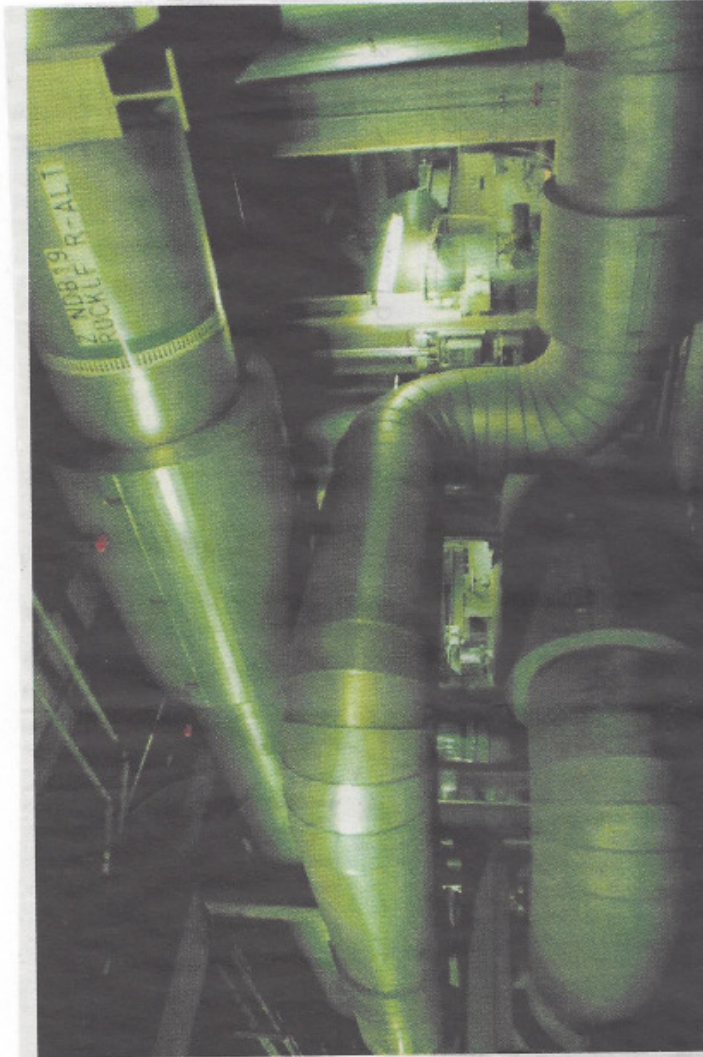
Energie für Berlin. Im Kraftwerk Reuter West wird über riesige Rohre Fernwärme in die Stadt transportiert. Foto: Daria Spiekermonte-Klaus
